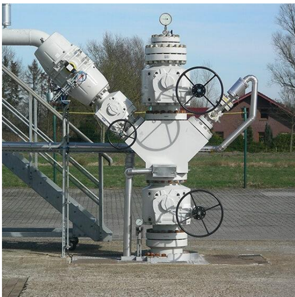
Abbildung 2.50: Bohrlochkopf einer Förderbohrung [21]
